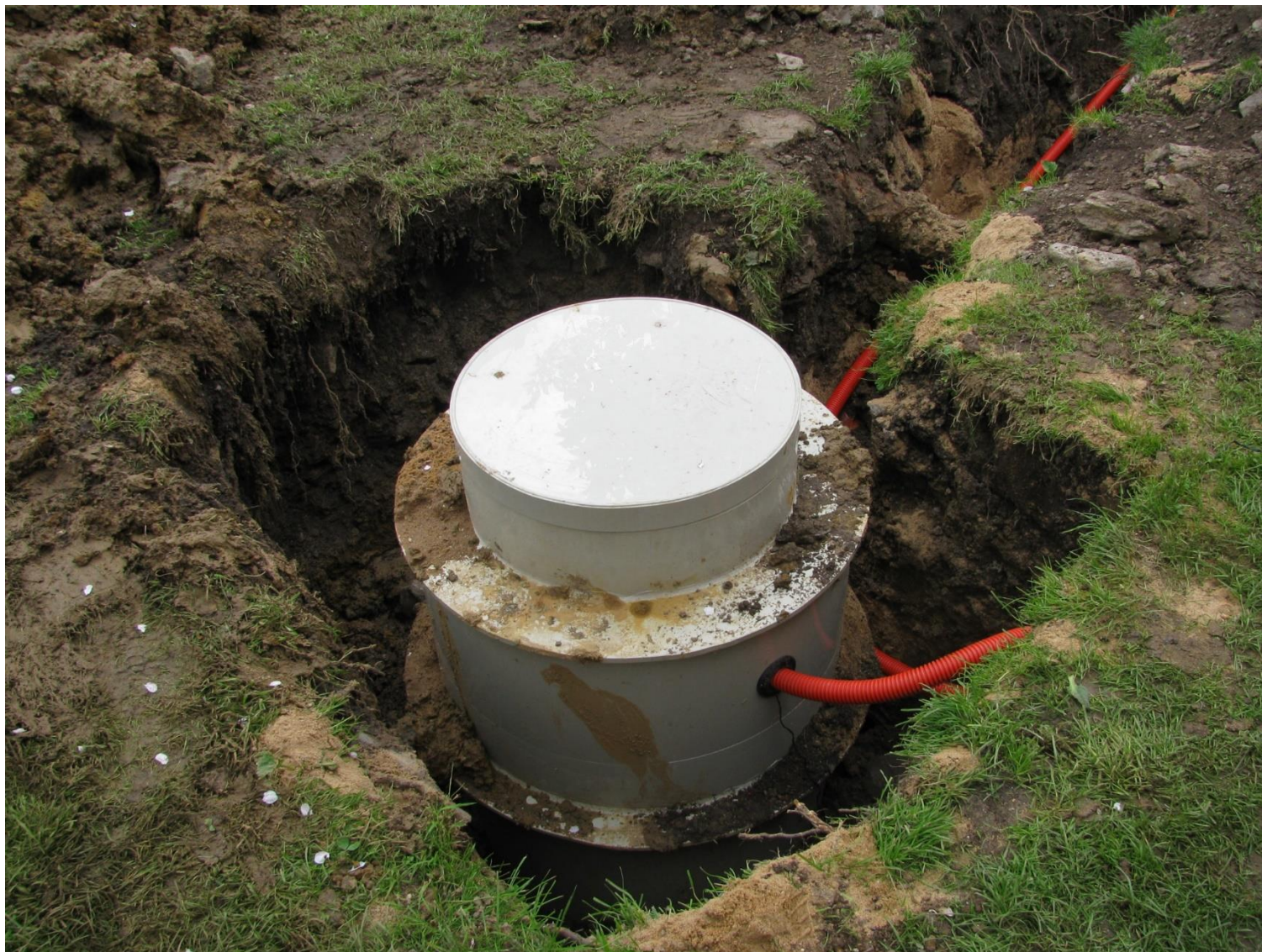
DOMOVNÍ ČERPACÍ JÍMKA
